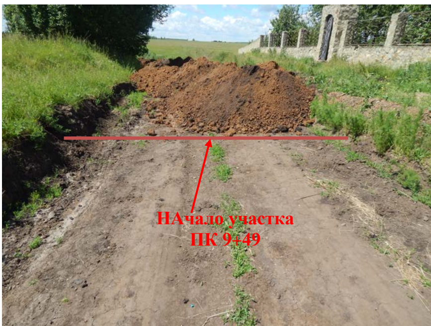
Фото 2.2. Местоположение начала обследуемого участка автодороги – ПК9+49 по ул.Садовая (створ жилого дома №35 по ул.Садовая) с.Каргалеи Вадинский район Пензенской области.
